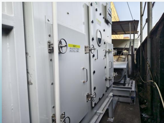
图：湖南省某公司新建设的“干式过滤/沸石转轮”设施
