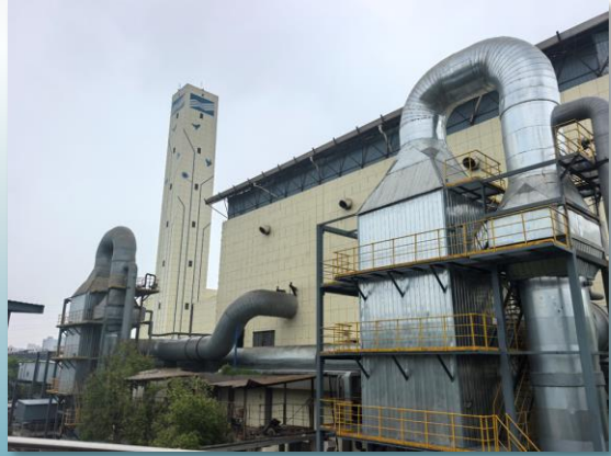
图：浙江某企业新安装的烟气SCR脱硝设施
